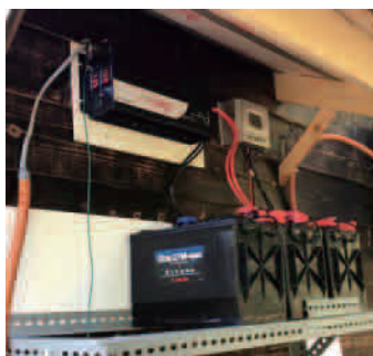
蓄電システム
